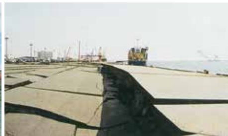
地面に亀裂が生じている岸壁
