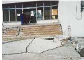
摩耶埠頭出張所 地面、階段に亀裂が入っている
