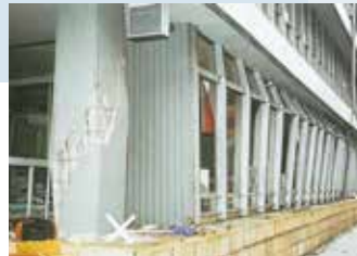
神戸外郵出張所(神戸港郵便局) 倒壊寸前のため立入禁止となった
